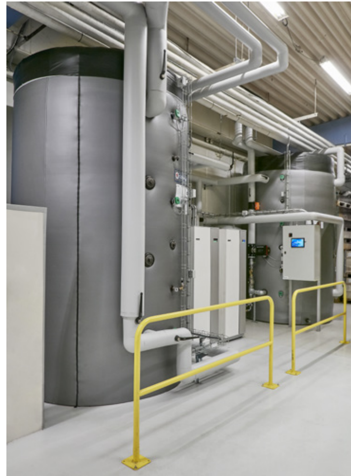
To varmepumper installeret i 2023, hvor procesvarmen genanvendes via et vand til vand varmepumpesystem, hvilket medfører en Co2 besparelse på 175 tons på årsbasis.
